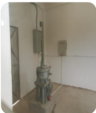
启闭机配电箱安装调试完成
